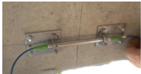
Sensore di deformazione in fibra ottica
