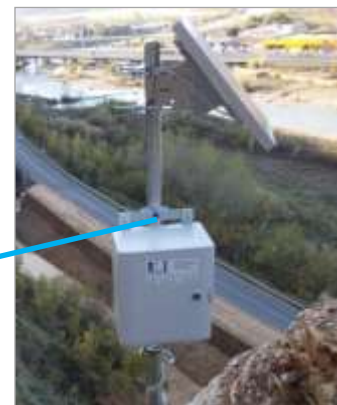
Centralina di allarme con GSM e/o webcam collegata al Centro di controllo operativo.
