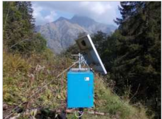
Unità di acquisizione dati
